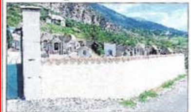
Plus de deux mois et demi ont été nécessaires pour la remise en état de la totalité des murs du cimetière de hameaux de Saint-Marcellin. Dans un triste état, ces derniers ont désormais retrouvé leur apparence initiale : crispis ocres et couvertures en tuiles roses. L'entrepreneur Michel Delaunay, est désormais en train de réaliser la suite du chantier, à savoir la réflexion des murs du cimetière de la commune.
