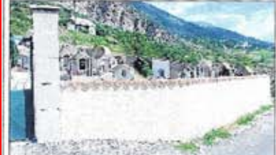
Plus de deux mois et demi ont été nécessaires pour la remise en état de la totalité des murs du cimetière de hameaux de Saint-Marcellin. Dans un triste état, ces derniers ont désormais retrouvé leur apparence initiale : crispis ocre et couvertures en tuiles roses. L'entrepreneur Michel Daniel, est désormais en train de réaliser la suite du chantier, à savoir la réflexion des murs du cimetière de la commune.
